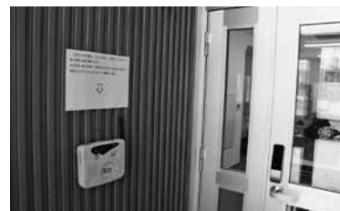
正面出入り口の緊急通報ボタン
