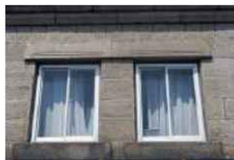
写真② 2階の縦長窓 かつては上げ下げ窓でした。 装飾されたまぐさが載っています。
